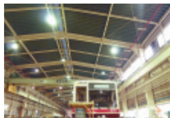
【車両基地照明】 北大阪急行電鉄株式会社
